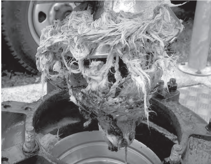
Verstopfte Pumpen, aufwändige Instandstellung.
